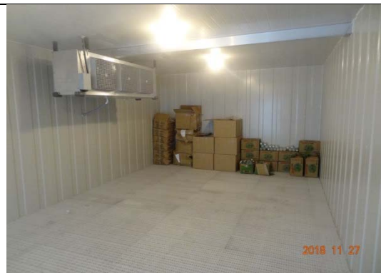
炊場新設冷凍庫
