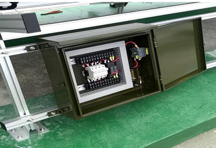
太陽光電發電系統-逆變器
