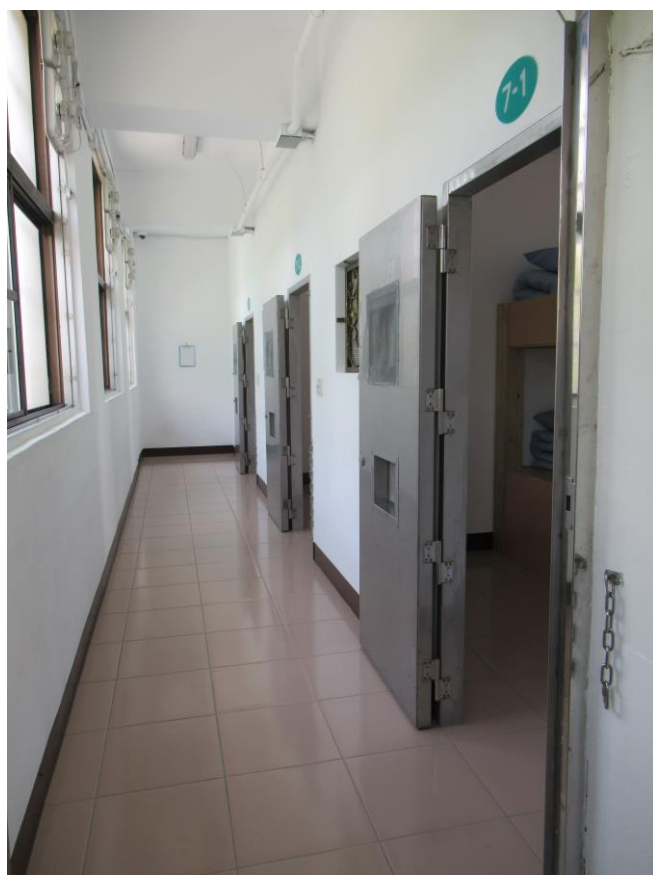
第三生活區-1、2、3 寢室走廊排風扇
