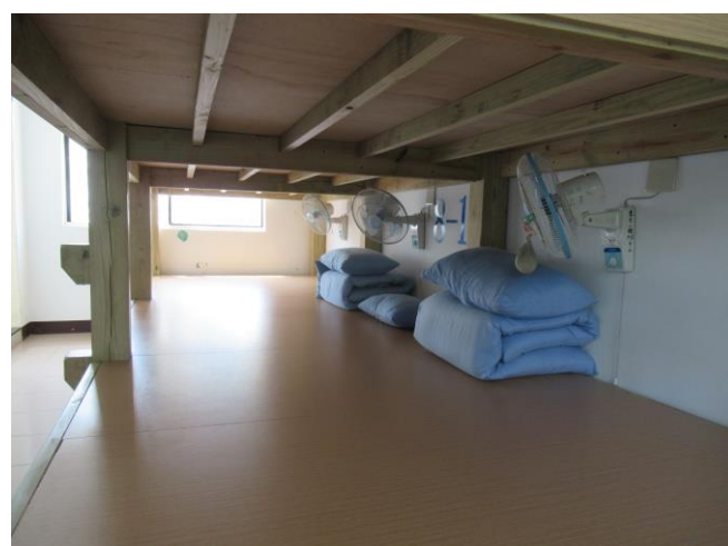
第三生活區-寢室 4 - 12 人房寢室-壁扇
