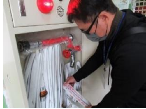
各場舍建置室內消防栓
