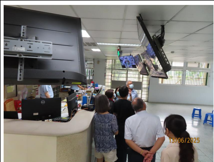
檢視勤務中心監視設備
