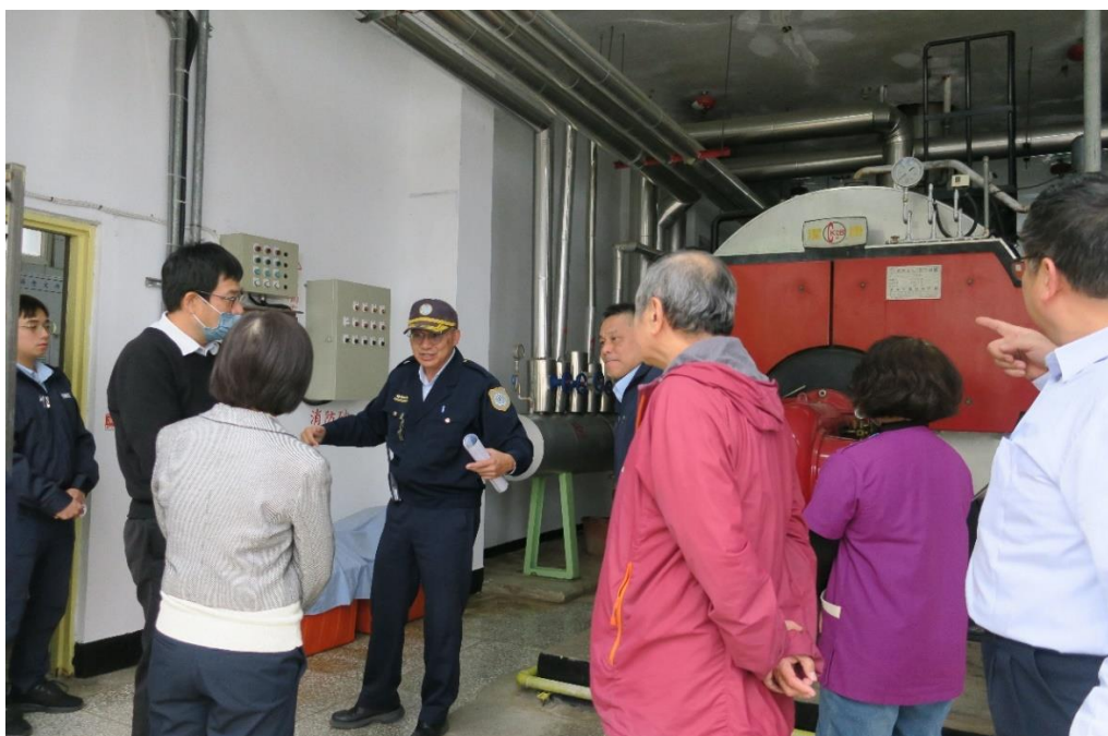
照片 2 外部視察小組委員參觀本監鍋爐設備(冬季燒熱水用)
