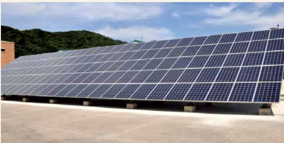
首爾南部監獄之太陽能發電板
