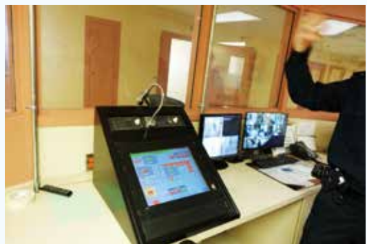
圖 25：凡尼爾女子中心舍房門、電燈及相關設備電子操作系統
