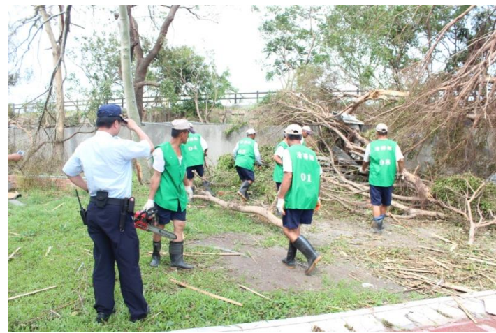
新生國中操場倒塌樹木清運
