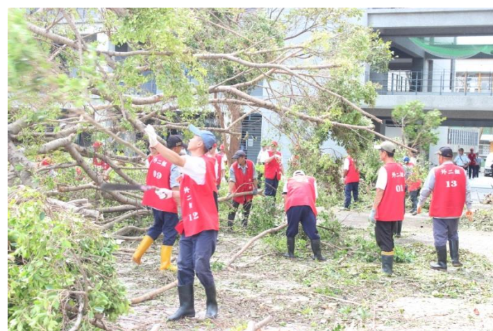
新生國中教學大樓前倒塌樹木清運
